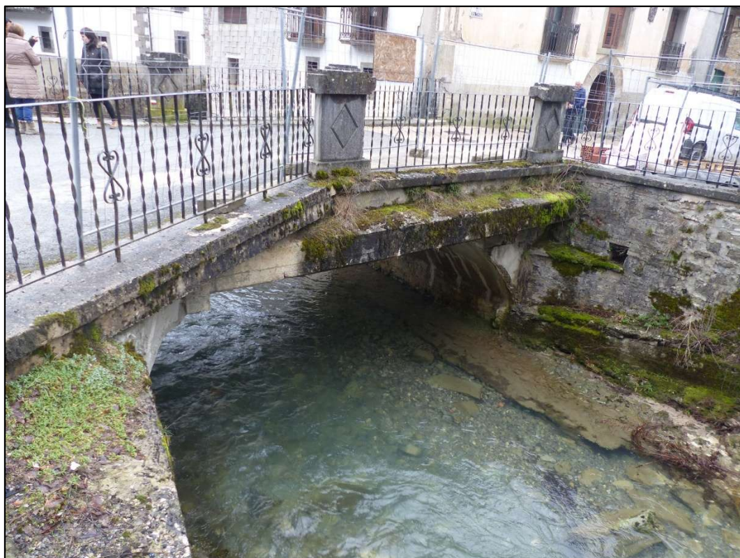
Figura 31. Fotografías de la zona del segundo puente de la localidad. Se trata de una zona, en la que como muestran las fotografías, el río circula muy encajonado. Se trata además de un puente que tiene una capacidad hidráulica relativamente baja y el tablero del mismo puede ser con relativa facilidad un obstáculo para la circulación del río en avenida.
